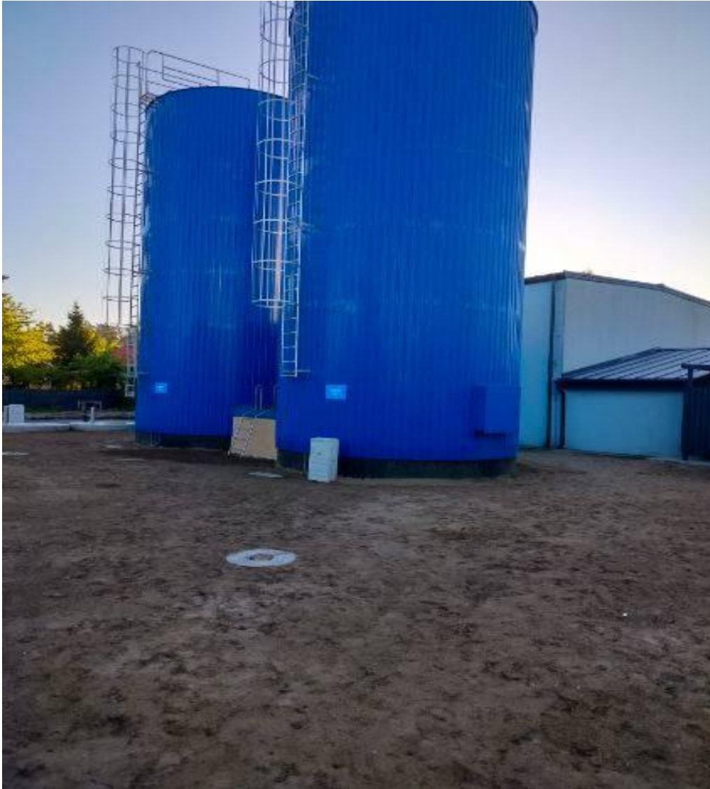
Fot. Stacja uzdatniania wody w Kruklankach
