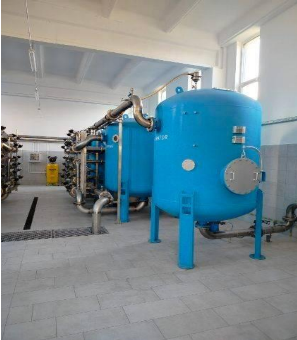
Fot. Stacja uzdatniania wody w Kruklankach
