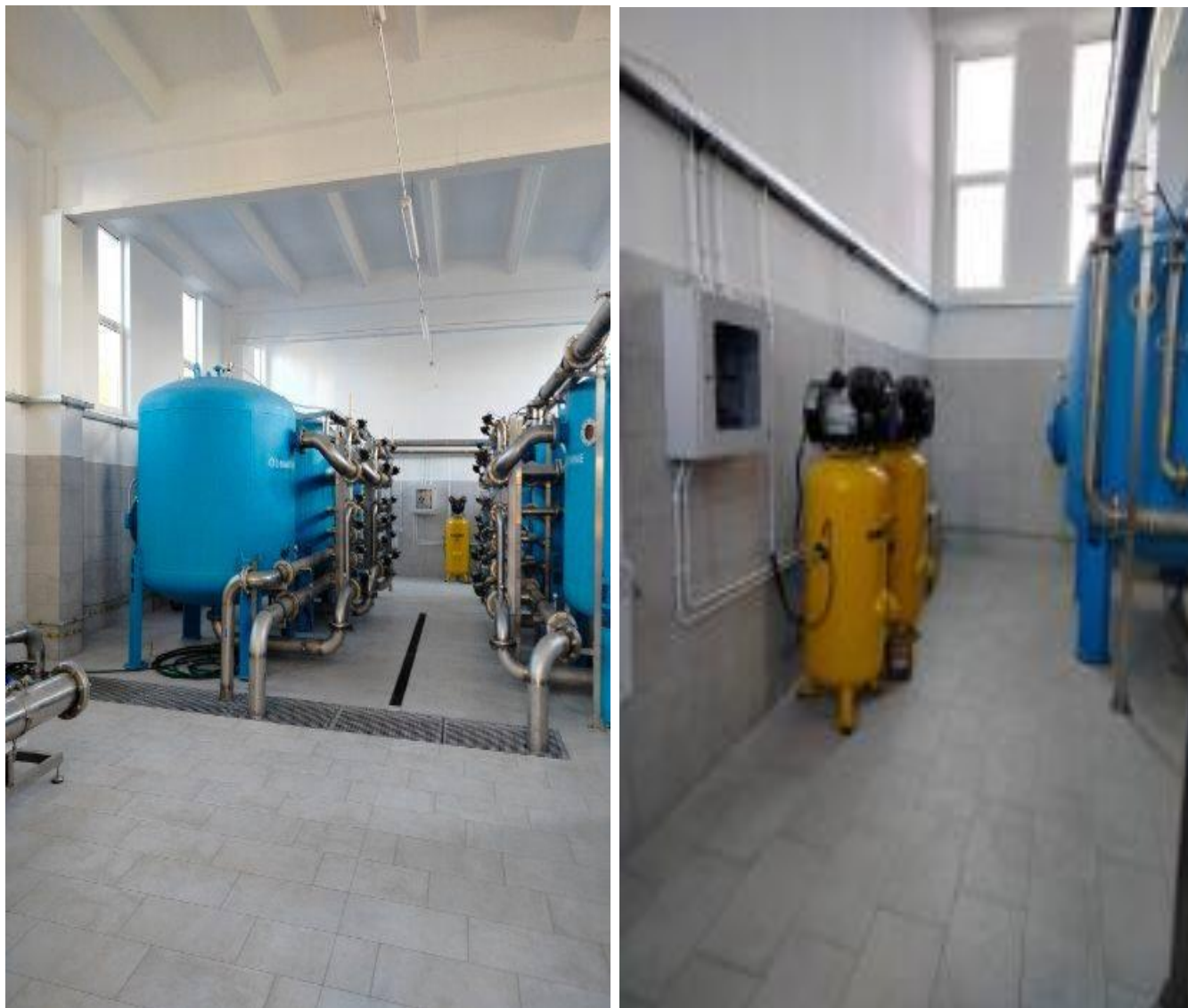
Fot. Stacja uzdatniania wody w Kruklankach
